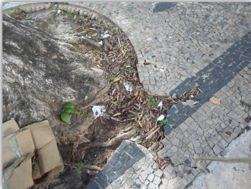
Figura 58. Danos causados por raízes de Licania tomentosa na calçada da Praça João Lisboa, Centro da Cidade de São Luís - MA/Brasil, 2016.
