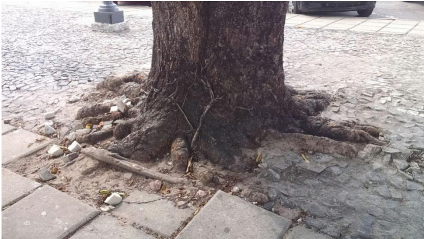
Figura 19. Raiz de mangueira ( Mangifera indica L.) causando danos em calçada na Praça da Fé no Centro Histórico de São Luís - MA.
