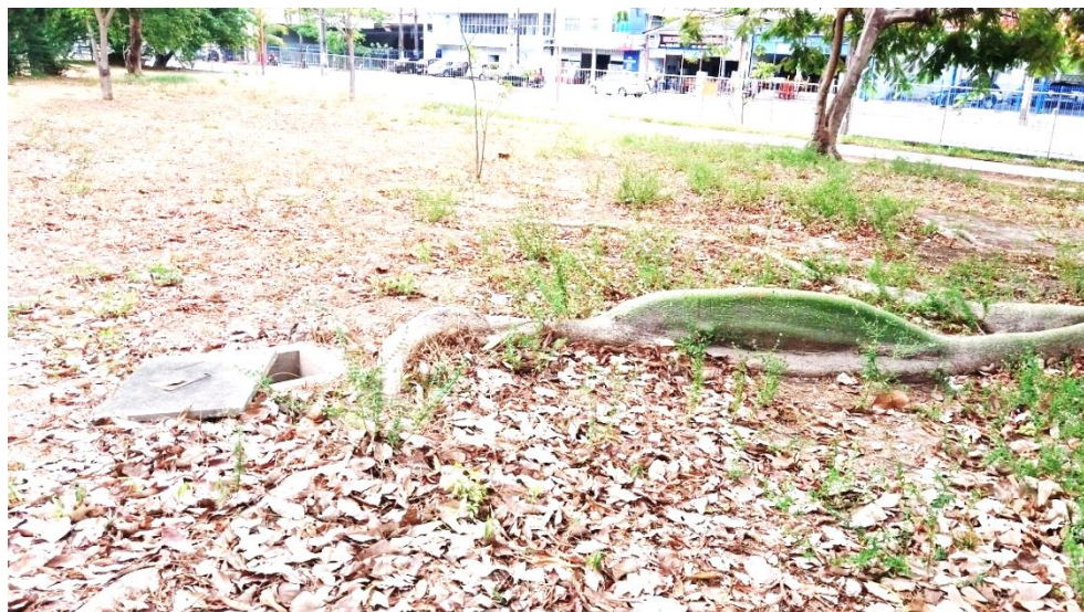
Figura 19. Raiz de Ceiba pentandra L. Gaerth em contato com ponto de rede elétrica subterrânea, Parque do Bom Menino São Luis-MA.
