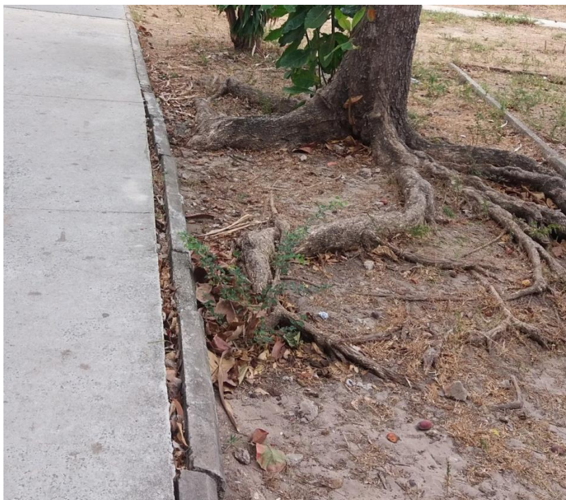
Figura 30. Amendoeira com raízes expostas com início de dano ao calçamento, Parque do Bom Menino, São Luís-MA.
