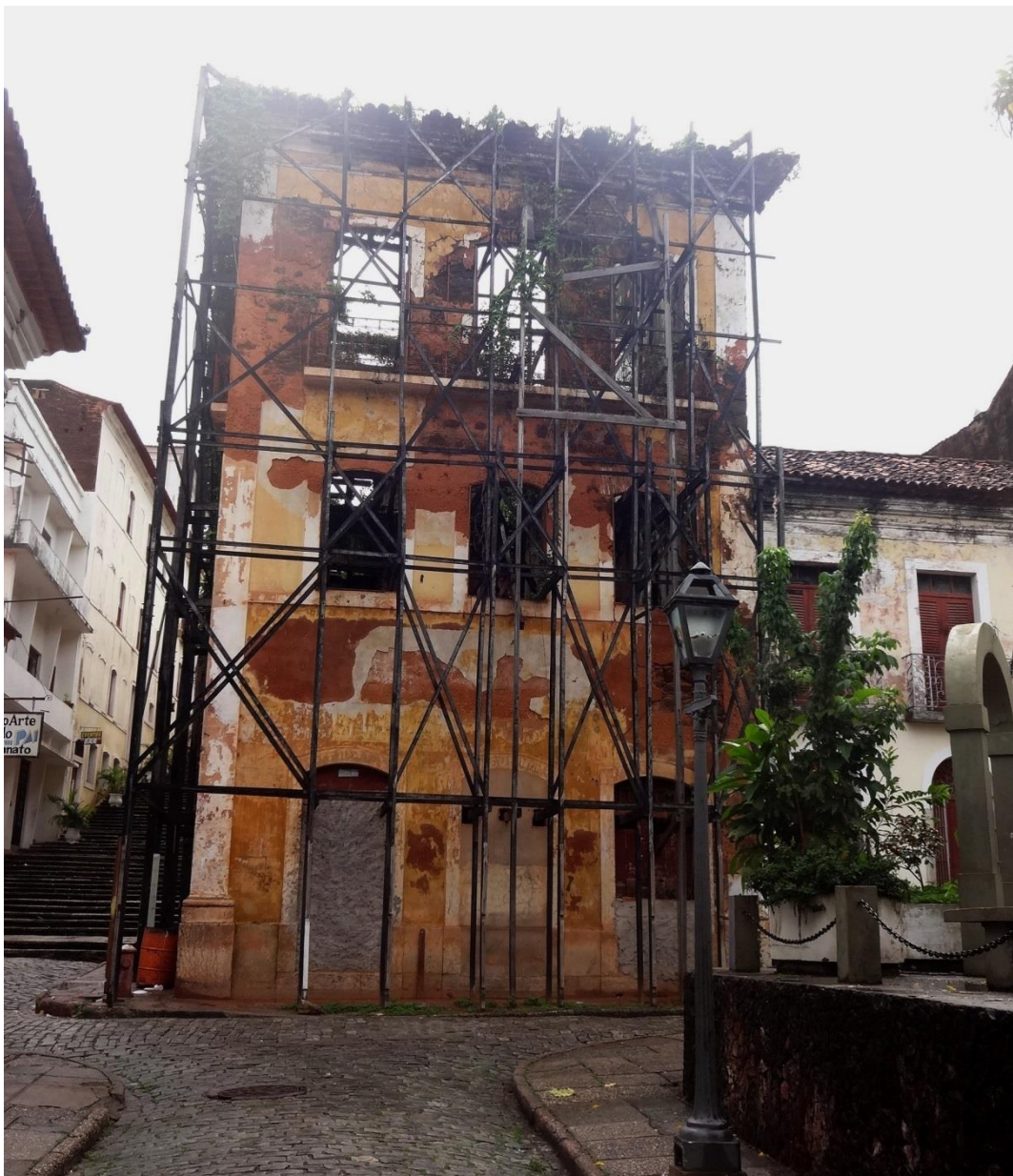
Figura 26 – Casarão em ruínas estabilizado. Fonte: Autoria própria
