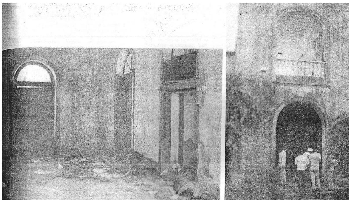
Figura 7 – Imóvel abandonado em processo de arruinamento. Fonte: O Estado do Maranhão 08/09/1987
